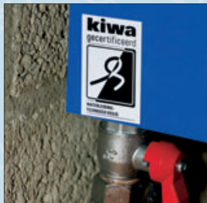
4. Sticker Verklaring Waterleidingtechnische veiligheid moet zichtbaar zijn bij de aansluiting aan het tappunt.
